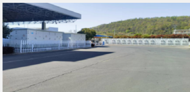
▲ 三花家用储能电站
