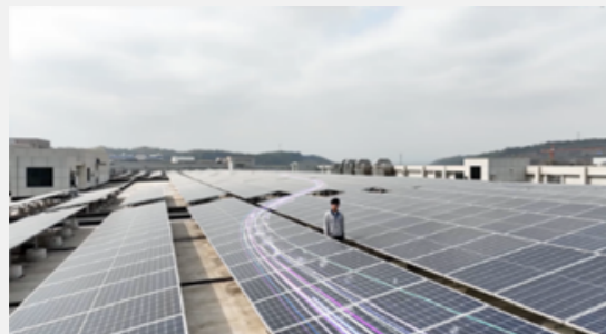
▲ 三花商用制冷太阳能光伏系统
