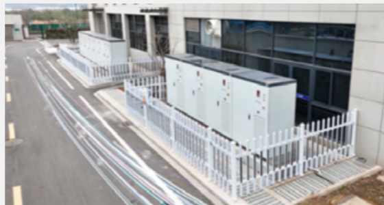
▲ 三花商用制冷储能电站
